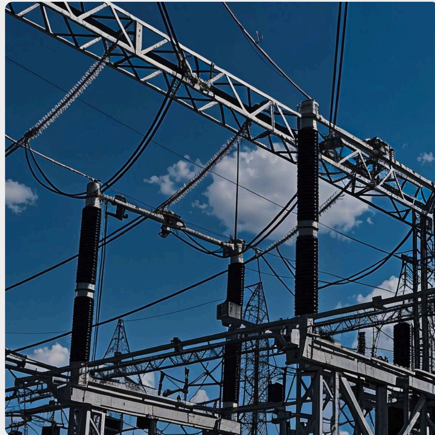
СТДМ-Э - Система технического диагностирования и мониторинга электроустановок
